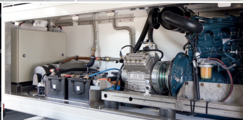
■ Trois niveaux de protection : EcoTransport, moteur et batteries de secours.
